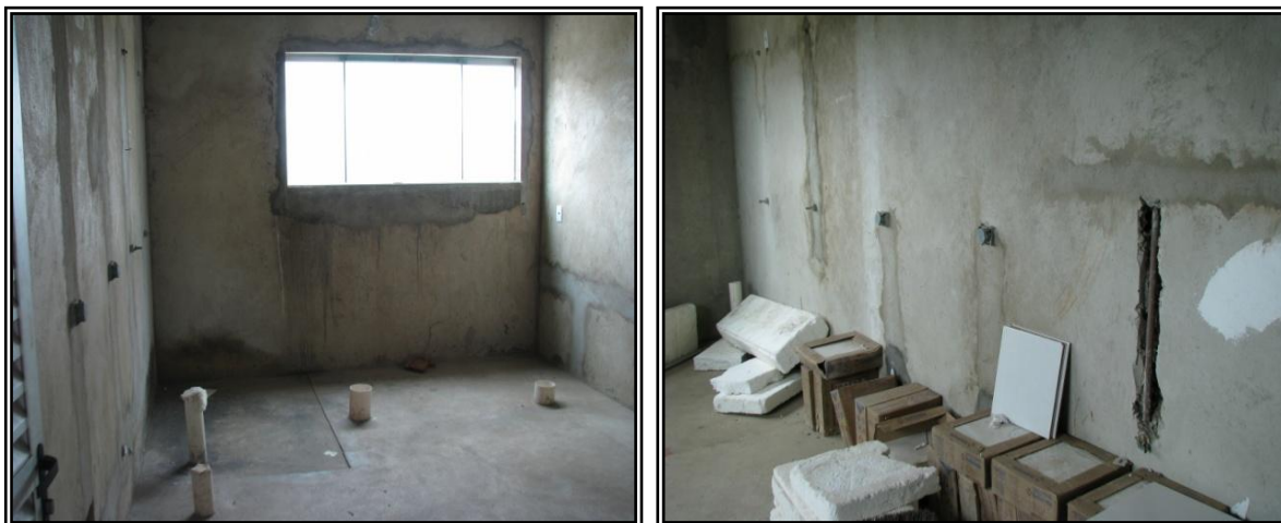
Piso dos banheiros não assentados e espaço ainda em construção inacabada.
